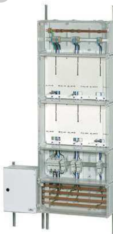
Para 5 contadores monofásicos e trifásicos e corte de 250A. Exemplo de montagem.
